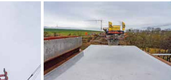
Ausblick in 25 Metern Höhe: Blick über das Teflon-Gleitlager auf den Vorschubsnabel, an dem Fahnen und Banner befestigt wurden.
