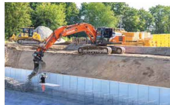
Entwässerungssystem: Das Oberflächenwasser wird durch eine Gabionenwand geführt, wo es bereits gefiltert wird.
